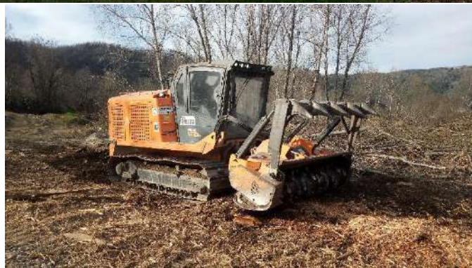
Secteur à embâcles traité par broyage
