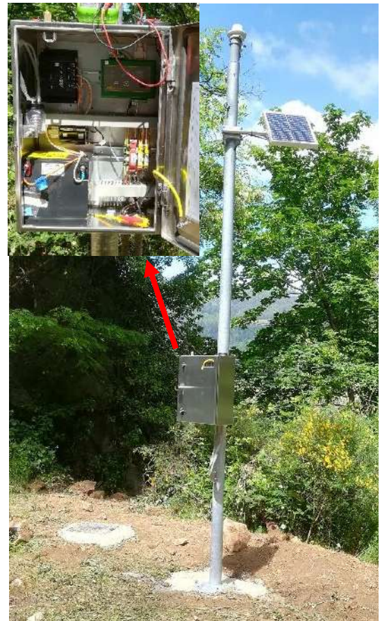
Centrale d'acquisition, capteur de précipitation et panneau solaire
