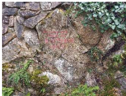
A restaurer à la passerelle de Mordane (Colombier le Vieux)
